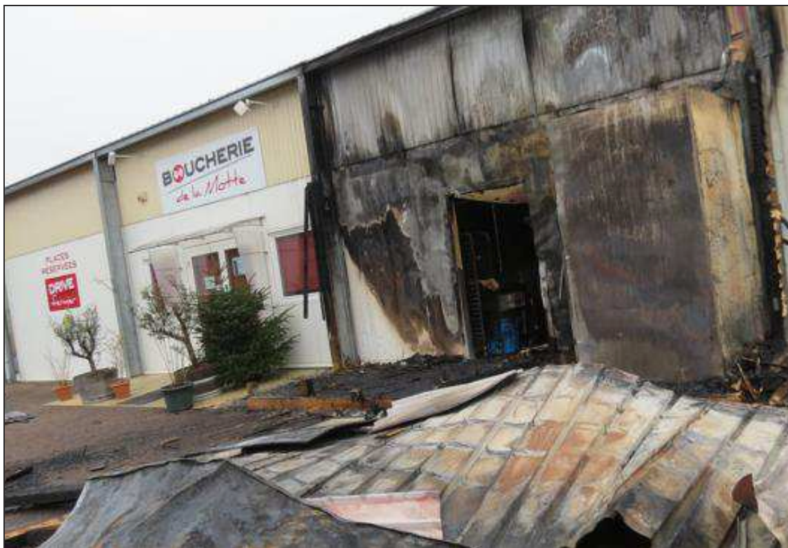
■ Samedi soir, le fumoir de l'abattoir de la Motte s'est embrasé. Les dégâts sont limités et ne perturberont pas la production. Photo ER
