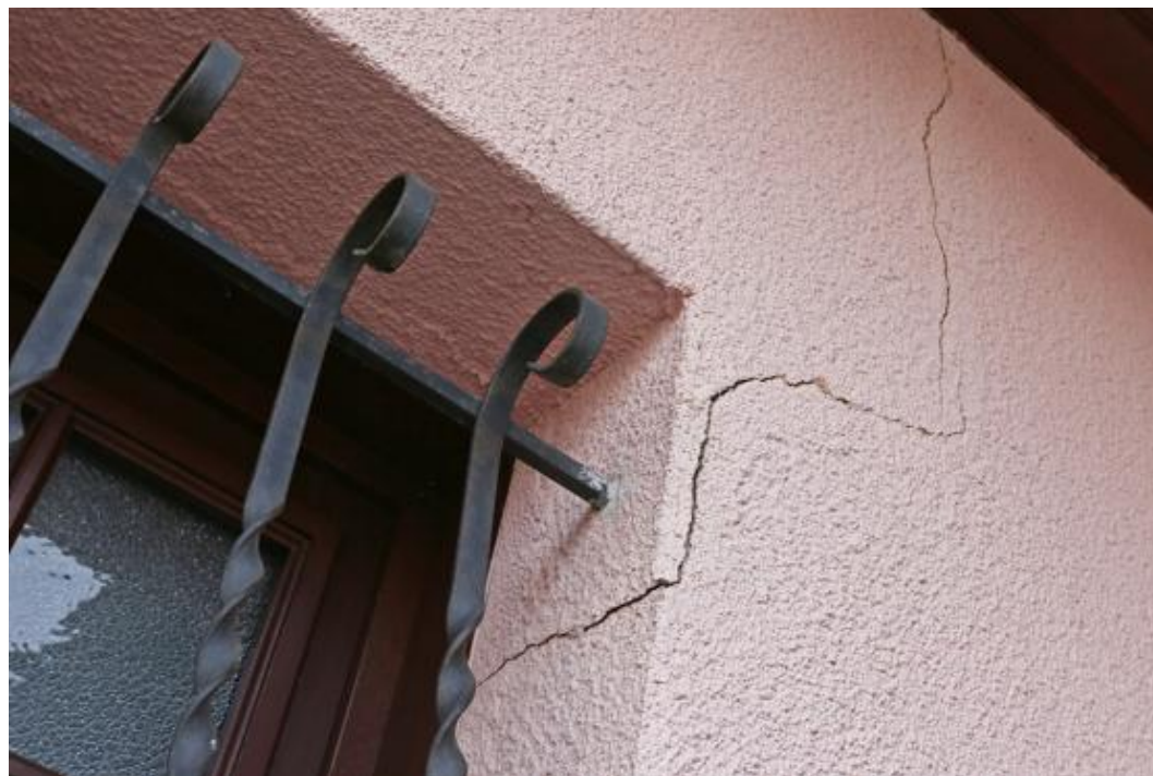
Les fissures sont apparues dès cet été dans les maisons de Pusey
